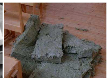
はがれた室内の石膏ボード
